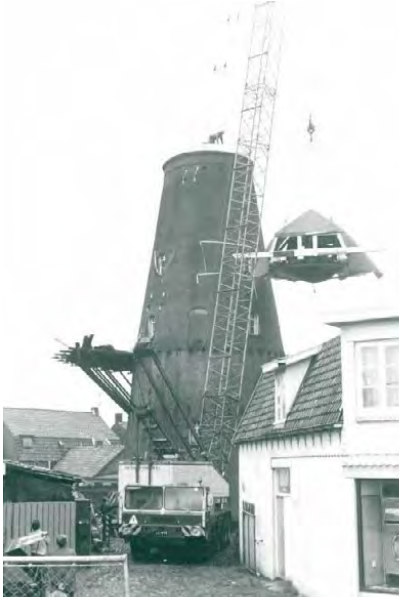
De molen gezien vanaf de Kruisstraat in 1977, tijdens de plaatsing van de gerestaureerde kop. Rechts op de foto de linker gevel van het woonhuis. BHIC 1685-032275.
