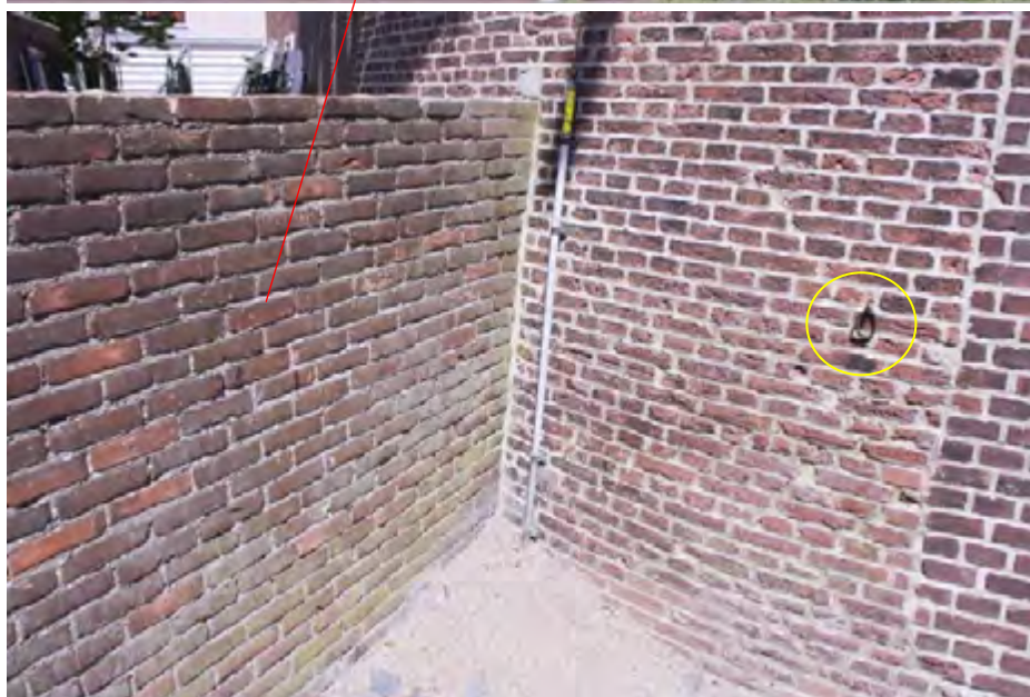
De scheidingsmuur aan de zijde van de Kruisstraat, gezien vanaf de voorzijde van de molen. Bij de cirkel is de smeedijzeren ring aangegeven zoals die bij een voormalige entree tot de molen in het muurwerk is opgenomen.
